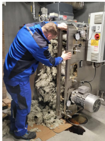
Kurz vor Weihnachten: defekte Pumpe, heisses Öl, Ausnahmezustand.
